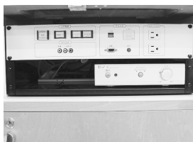
写真2 ICT機器BOX
