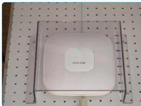
無線LANアクセスポイントを設置する際に カバーをつけた例
